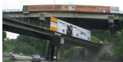
Papan iklan jejambatan yang dipasang secara menyerong memberi gangguan serta membahayakan pengguna jalan raya dan tidak dibenarkan.
